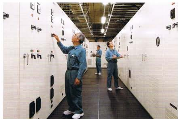
変電設備点検
